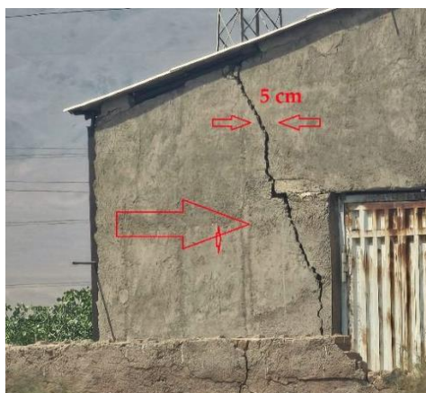
شکل ب-۱- ترک خوردگی در سوله صنعتی ناشی از فرونشست زمین (اشتهارد)
